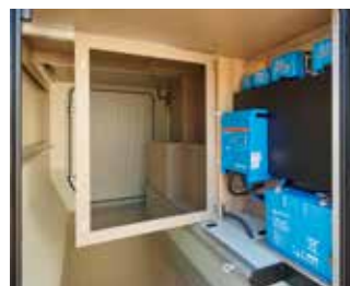
Garage med elcentral
