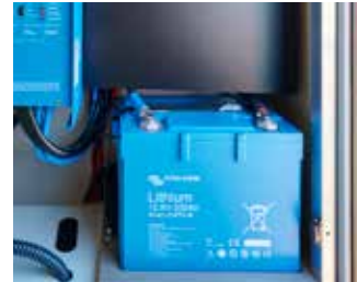
Batería de litio
